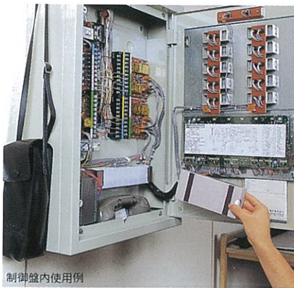
制御盤内使用例
